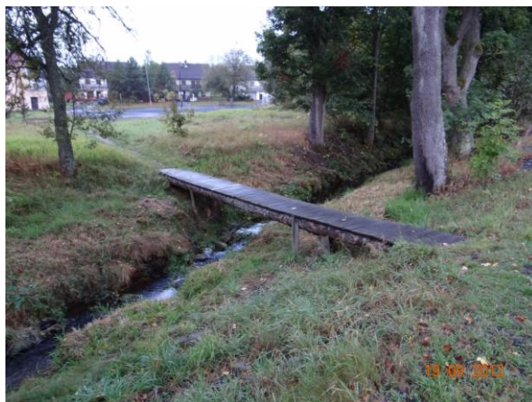
Lávka u obecního úřadu - hrozí stržení.
