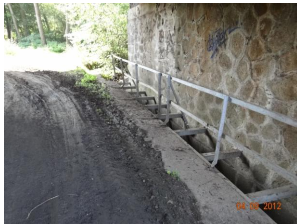
Úzké koryto pod viaduktem - místo pravidelného rozlivu a destrukce koryta.
