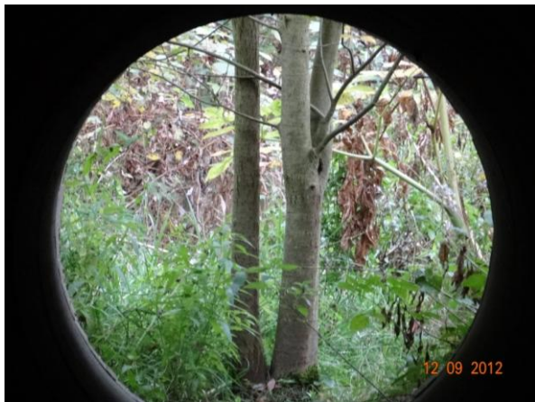
Přímo před vyústěním propusti vyrůstají stromy.
