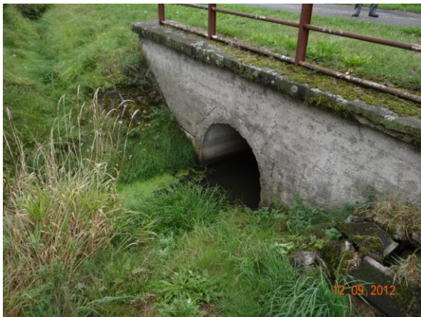
Detail nekapacitní trubní propusti.
