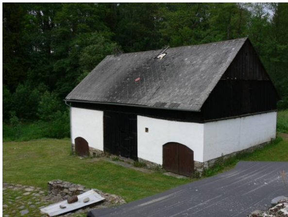
Ohrožená nemovitost č.p. 195 - objekt stodoly.
