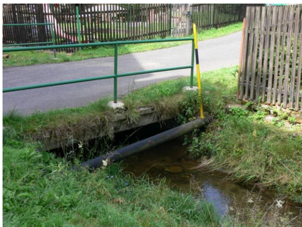
Nekapacitní mostek k bytovým domům - kritický profil pro nápěch a rozliv.
