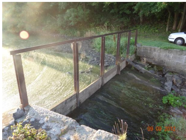
Částečně hrazený bezpečností přeliv Křížového rybníka.
